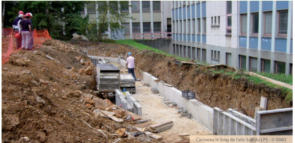
Caniveau le long de l'aile Sud du LPS - © ISMO
