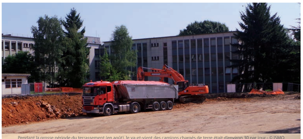
Pendant la grosse période de terrassement (en août), le va-et-vient des camions chargés de terre était d'environ 30 par jour - © ISMO
